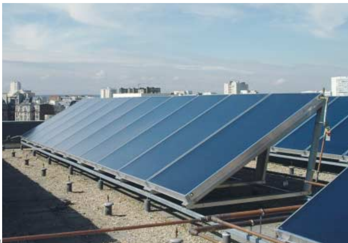
Trois groupes d'immeubles de l'OPAC de Paris sont équipés de capteurs solaires thermiques (1 500 m 2 ) qui couvrent 40 % des besoins en eau chaude.
